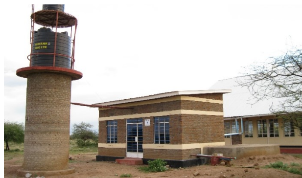
Wasserturm, Filterhaus und Versammlungshalle, welches die Zisternen mit Wasser speist
